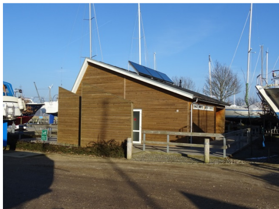
Servicebygningen på Marina Syd kan evt. genanvendes, men trænger til indvendig renovering.
